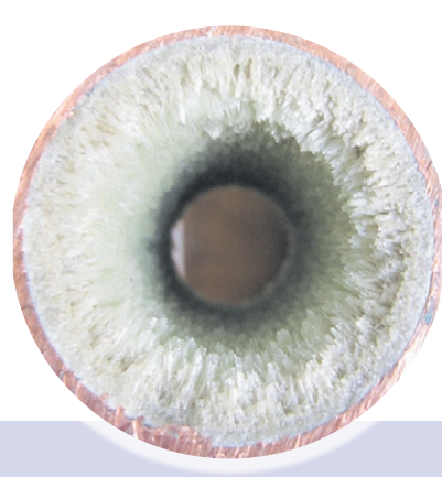
Kalkkikerrostumaa lämpimän käyttöveden putkessa.
