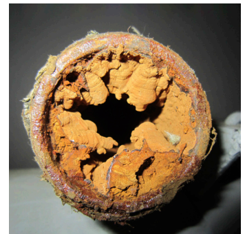
Kalkavlagringar och rost i vattenledning
