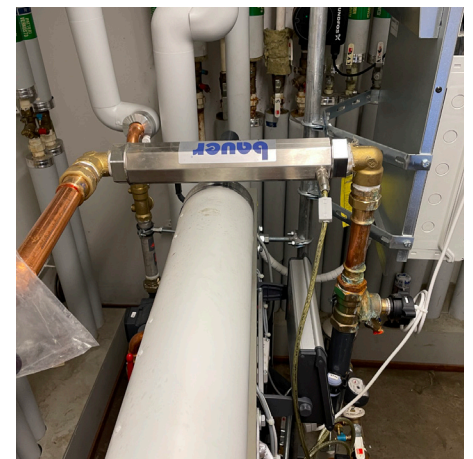
Vattenbehandlingssystem ansluten till värmesystemet
