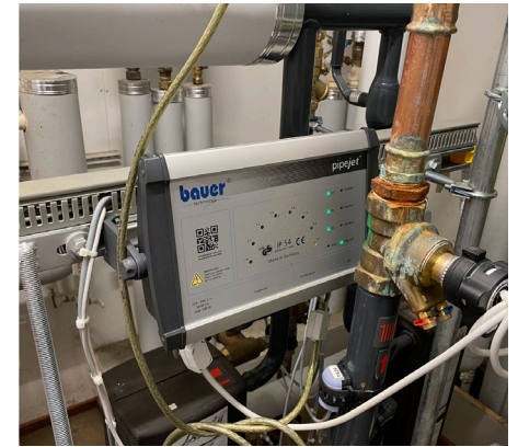
Styrenhet för vattenbehandlingssystemet
