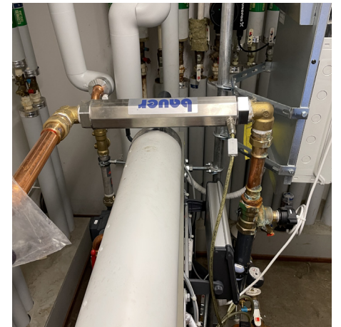
Vedenkäsittelyosa liitettynä lämmitysjärjestelmään
